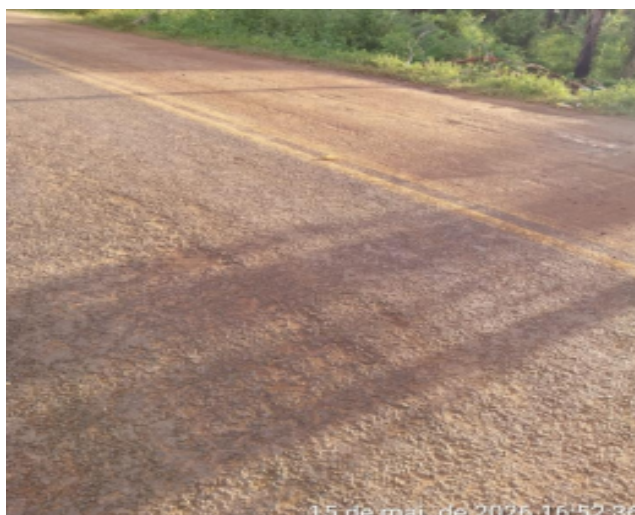
Figura 4 - Exemplo da Patologia Desgaste superficial e fissuras iniciais
