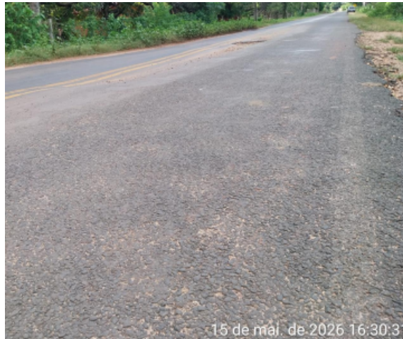
Figura 5 - Exemplo da Patologia Irregularidade e mancha
