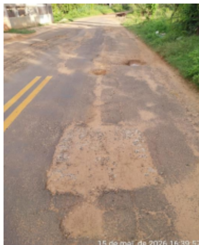
Figura 6 - Exemplo da Patologia buracos (potholes) e desgaste
