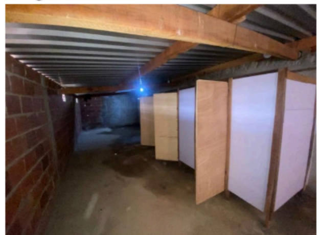
Figura 6 - Cabines das bacias sanitários
