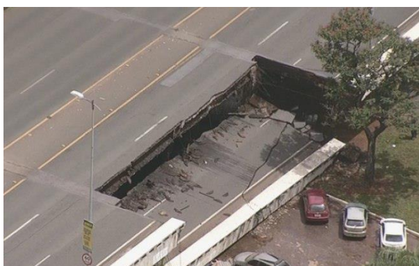
Fig. 2. Viaduto do Eixão Sul em Brasília após desabamento.
