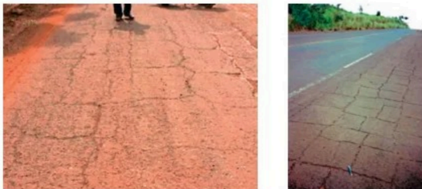
Figura 9 – Trinca interligada tipo “bloco”
