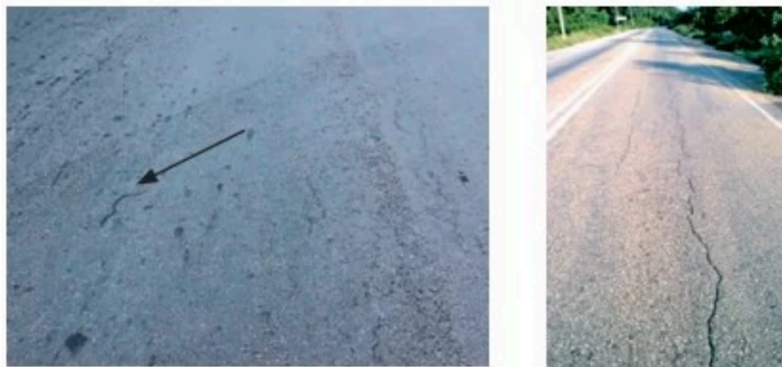
Figura 7 – Trinca Isolada Longitudinal
