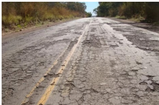
Figura 5 – trincas em pavimento asfáltico.
