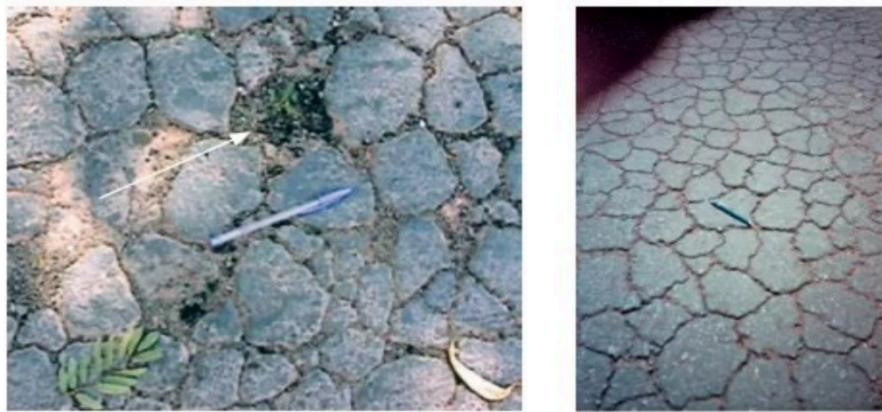
Figura 8 – Trinca tipo Couro de Jacaré
