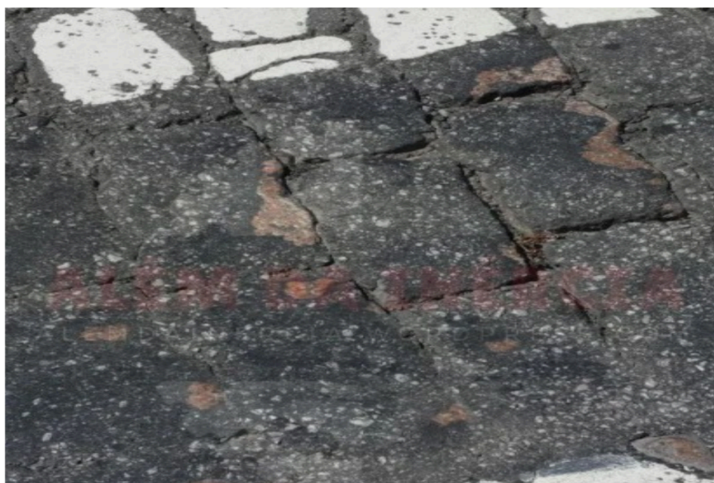
Figura 10 – Trincas de Reflexão
