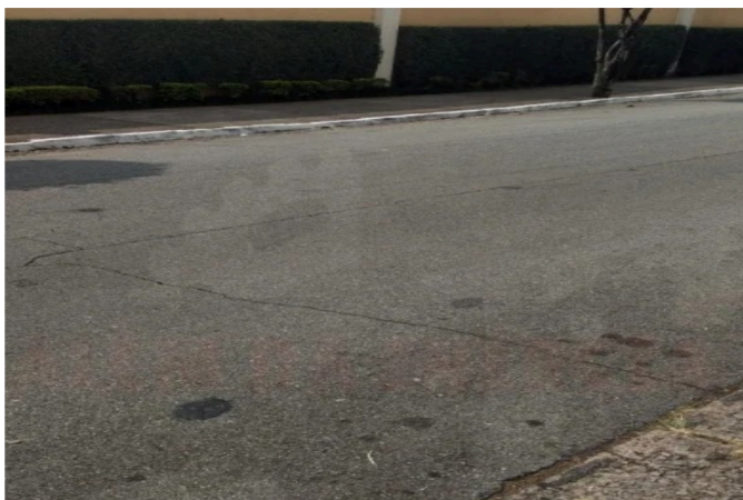
Figura 6 – Trinca Isolada Transversal
