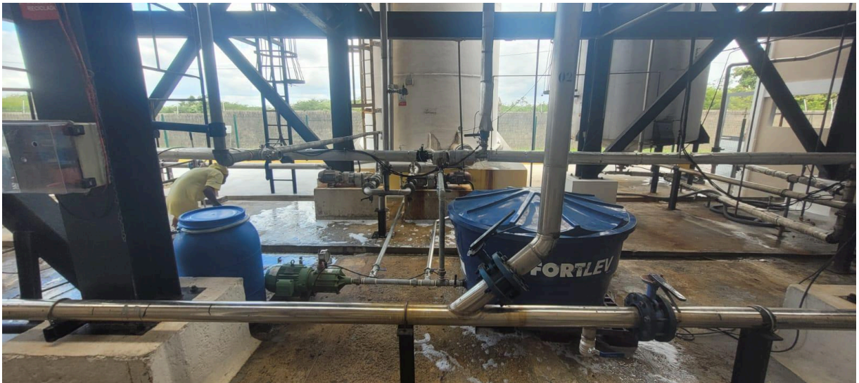
Figura 8 - Foto das válvulas utilizadas na empresa
