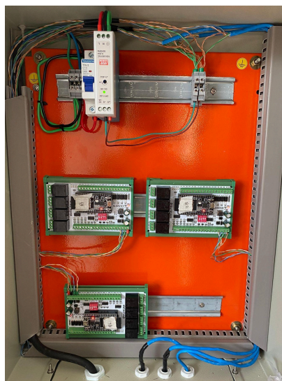
Figura 3 - Quadro elétrico com os três microcontroladores
