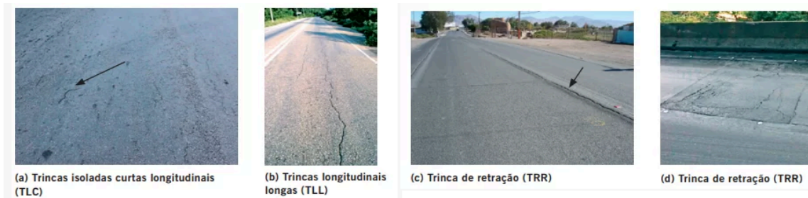
Figura 3: Patologia tipo Trincas e de Retratação
