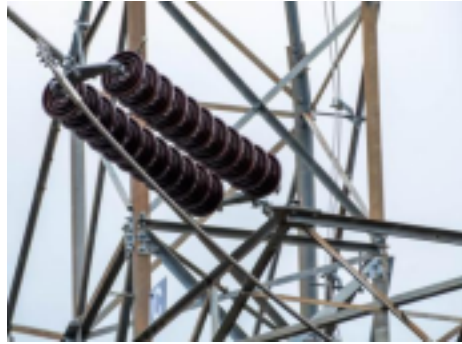
Figura 1. Isoladores de porcelana em linhas de transmissão
